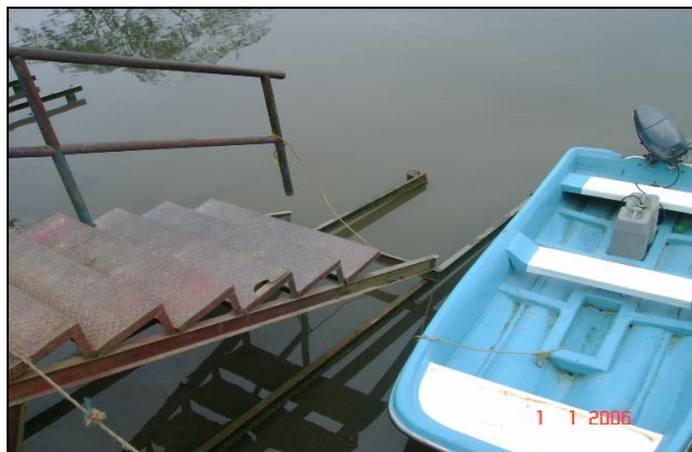
Figura N° 12. Estructura dañada muelle de la alcaldía Fuente propia
