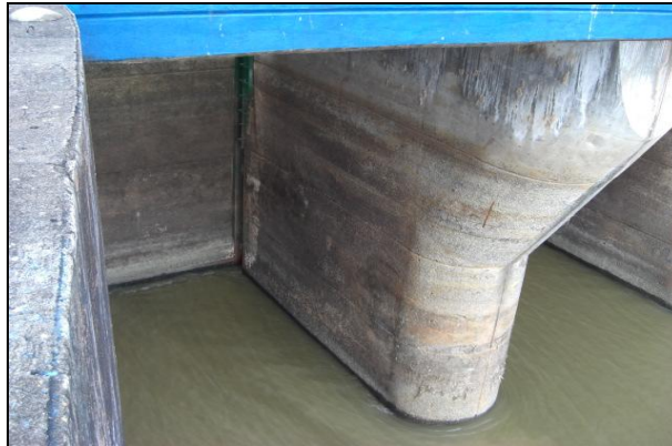
Figura N° 4. Vista General de las compuertas de cierre del Caño Mánamo Fuente Propia
