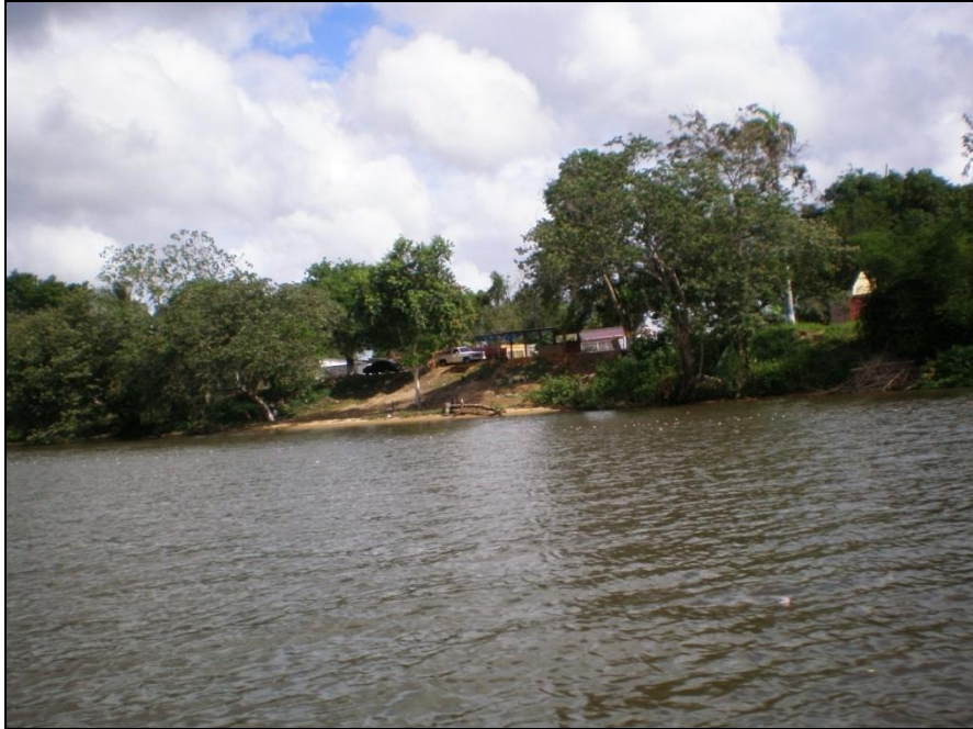
Fotografía N° 56. Vista frontal del desnivel existente entre la costa y la carretera Fuente propia
