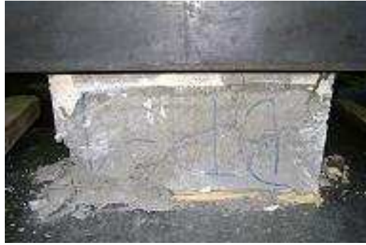
Fig. 4.2 Falla de borde
