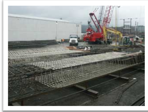
Imagen 1.7.: Estacion CSO Tri Met, Portland, Oregon.
