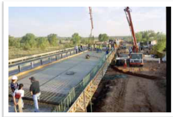
Imagen 1.2. Fase de construcción del Puente Sierrita de la Cruz, Texas. USA. Fuente: http://www.hughesbros.com/Aslan100/Aslan100_GFRP_rebar.html
