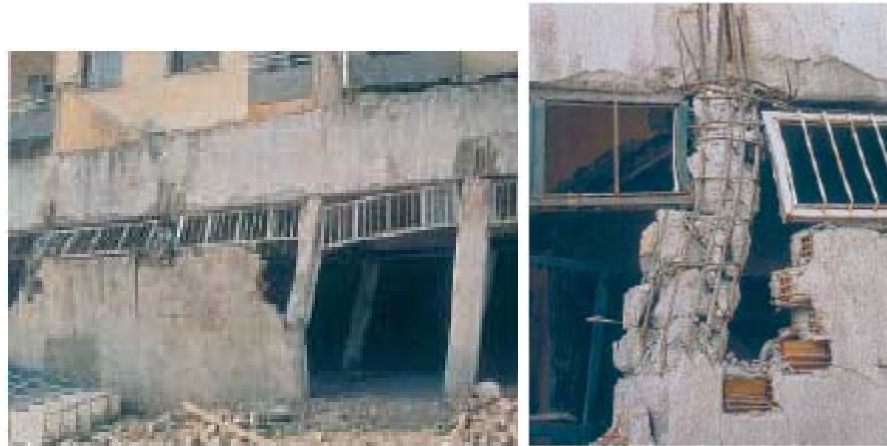
FIG. 9.2 Falla a corte en columnas por paredes adosadas (Seismic Conceptual Design of Buildings. Hugo Bachmann)
