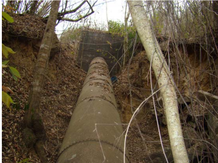
Figura 4. 18 Vista de la tubería saliendo de la cámara de carga
