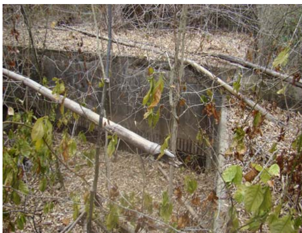
Figura 4. 14 Rejilla contra basura entre el desarenador y la cámara de carga
