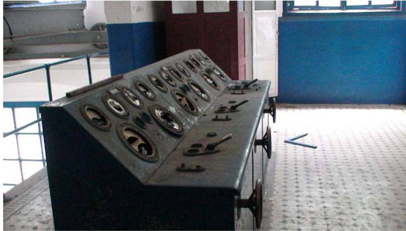
Figura 4. 21 Vista actual del tablero de control
