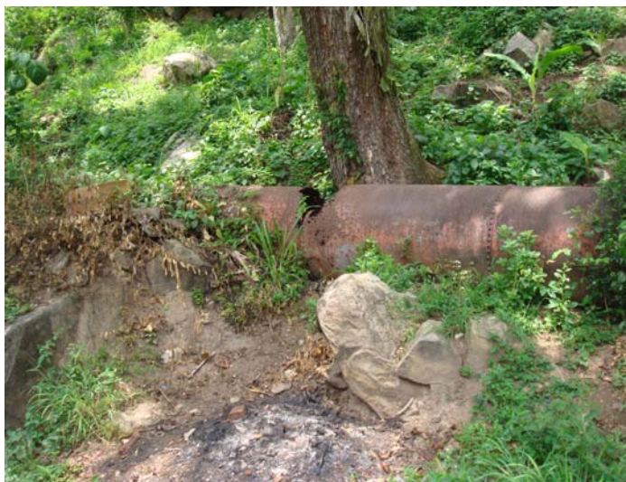
Figura 4. 16 Sección de tubería destruida por la corrosión
