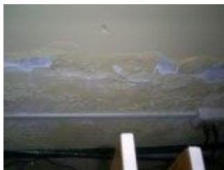
Figura C1-5. Presencia de filtraciones en la Biblioteca "Profesor Ramón A. Villarroel"
