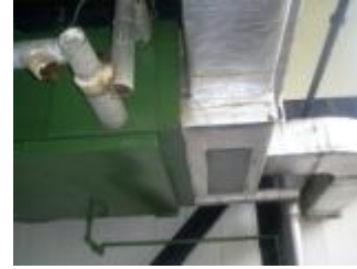
Figura C1-2. Toma de aire bloqueada
