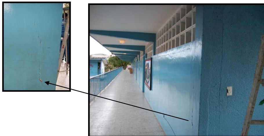
Figura IV.1.2.5 Grieta longitudinal en la columna. (2) Fuente: Elaboración Propia
