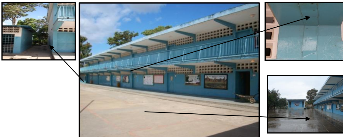
Figura IV.1.2. Se observan los módulos alineados unidos por una junta de construcción Fuente: Elaboración Propia
