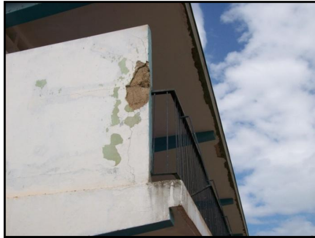
Figura IV.3.2.1 Deterioro de mampostería en pared Fuente: Elaboración Propia
