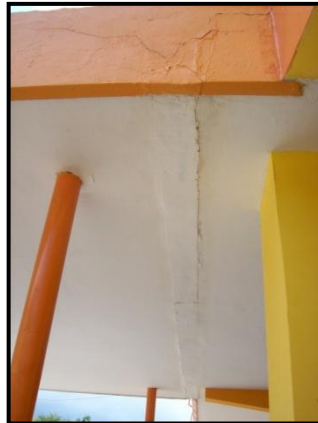
Figura IV.2.2.3. Grietas en la junta de construcción Fuente: Elaboración Propia
