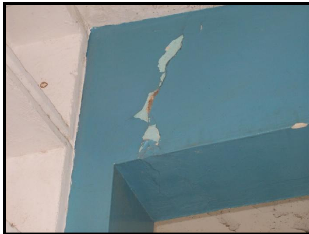
Figura IV.1.2.3 Grieta transversal en viga alta. Fuente: Elaboración Propia
