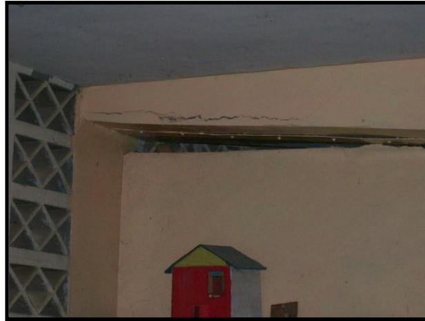
Figura IV.1.2.4 Grieta longitudinal en viga alta. Fuente: Elaboración Propia
