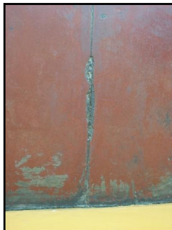
Figura IV.2.2.2. Fisura en el acabado de piso del nivel entrepiso de la edificación Fuente: Elaboración Propia
