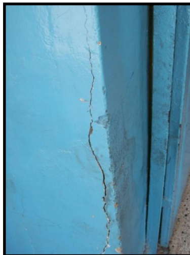
Figura IV.1.2.1 Grieta longitudinal en la columna. (1) Fuente: Elaboración Propia
