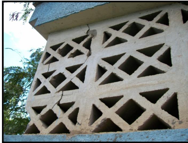
Figura IV.1.2.2 Grietas en los bloques de ventilación. Fuente: Elaboración Propia
