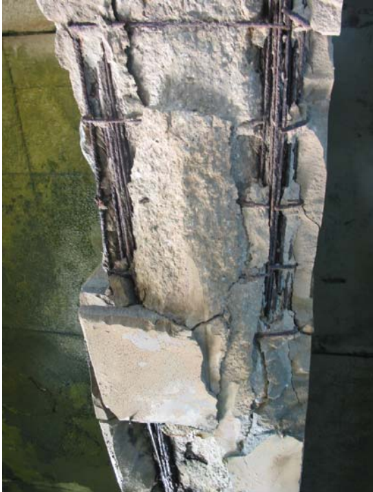
Desprendimiento Grave de Concreto en el Patín Inferior de la Viga Postensada
