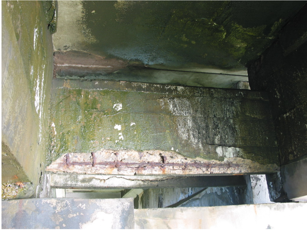
Oxidación Grave en el Separador
