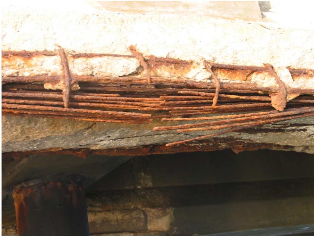
Cables de Postensado Rotos
