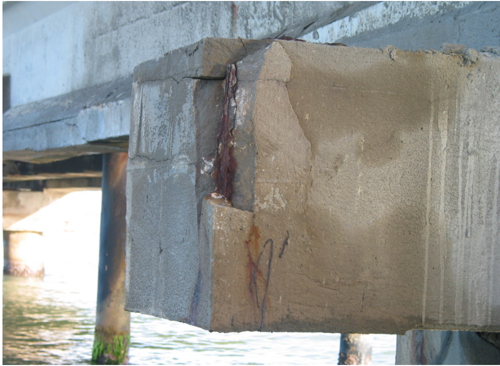
Desprendimiento de Concreto en la Esquina del Cabezal
