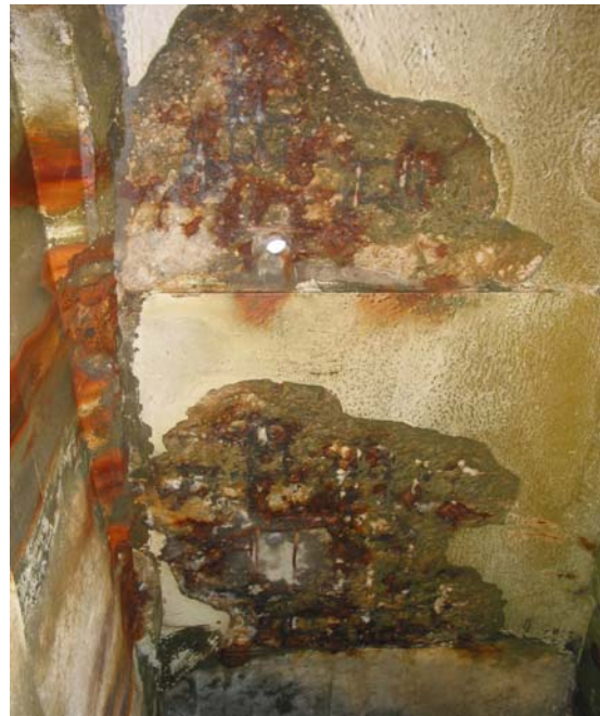
Oxidación Grave en la Cara Inferior de la Losa
