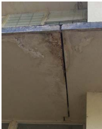
Figura IV.3.26 Deterioro en Junta de Fachada Norte entre Módulo I y II en Planta Alta
