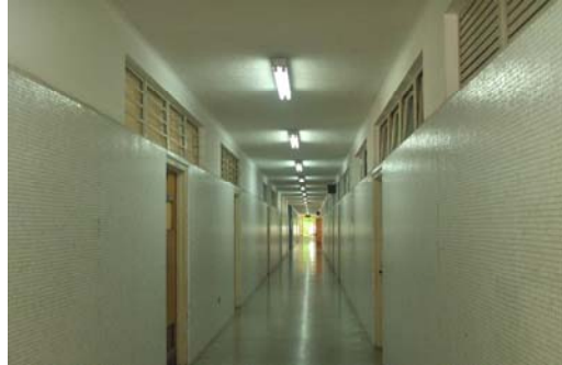
Figura II.2.10 Corredor de Planta Baja - Pabellón Oeste del Edificio Principal del Instituto de Medicina Tropical Dr. Félix Pifano
