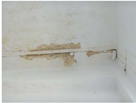
Figura IV.3.25 Deterioro en Junta Interna entre en Módulo I y II en Planta Techo
