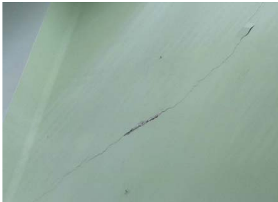
Figura IV.3.19 Grieta a 45° en Pared
