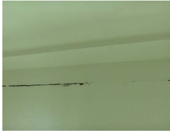
Figura IV.3.27 Junta con Recubrimiento entre el Módulo II y III en Planta Techo
