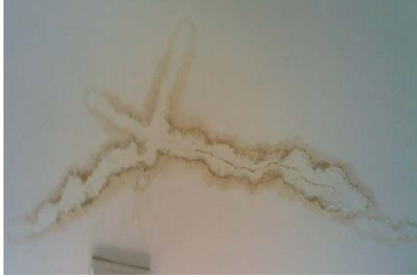
Figura IV.3.21 Humedad en Losa de Planta Techo
