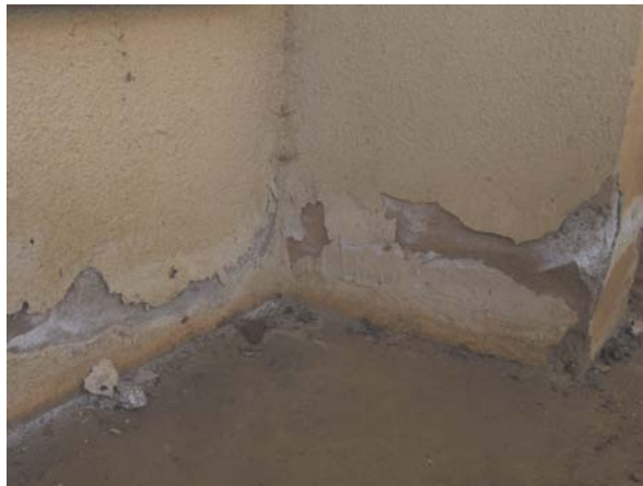
Figura IV.3.22 Delaminación del Concreto en Columna
