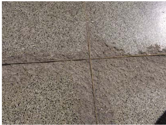
Figura IV.3.23 Desgaste de Piso de Granito en el Hall de Entrada
