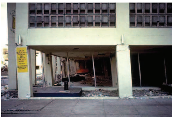
. Edificación con entrepiso débil
