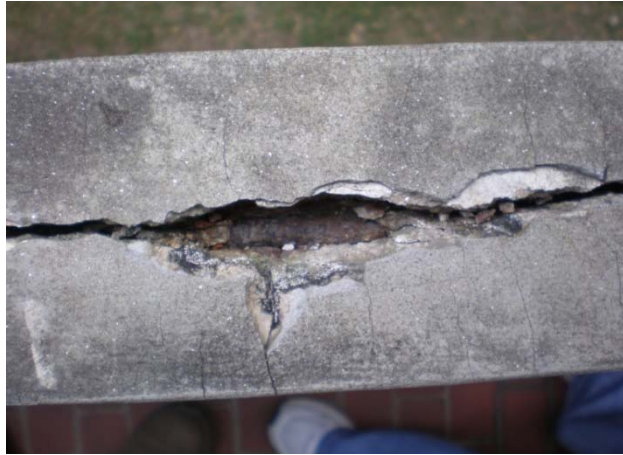
B.3.1. Acero corroído en pared (Módulo 1-Nivel 1)
