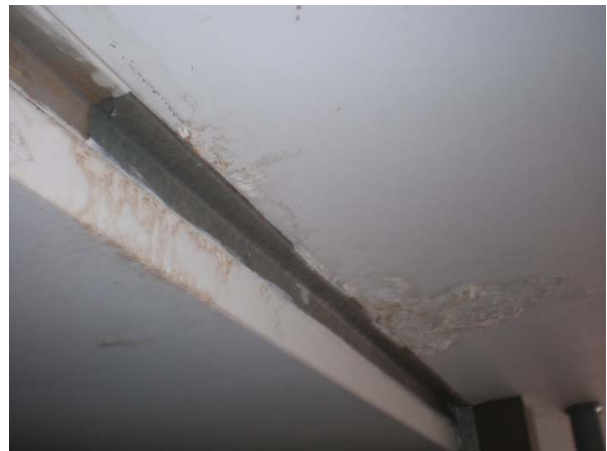
B.1.3. Problema de humedad en losa (Módulo 3-Techo)
