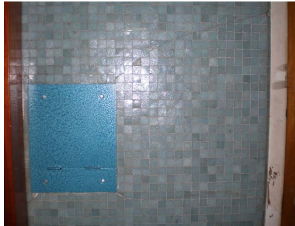
B.5.1. Fisura de mosaico por acción de tornillos (Módulo 4-Nivel 1)
