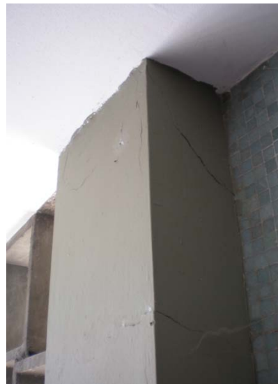
B.4.3. Fisura en caras de una columna. (Módulo 9-Nivel 1)
