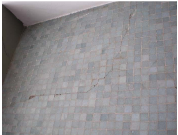
B.5.3. Fisura en mosaico de pared (Módulo 5-Nivel 1)
