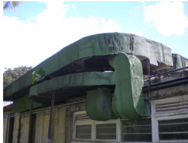
B.6.3. Capa vegetal en ductos de aire acondicionado (Módulo 6-Nivel 1)
