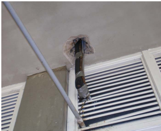
B.2.2. Abertura en losa no planificada y sin recubrimiento. (Módulo 3-Techo)
