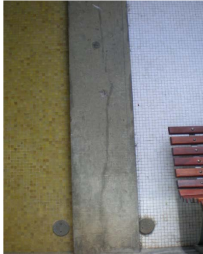
B.4.1. Fisura en dirección al acero longitudinal (Módulo 5-Planta baja)
