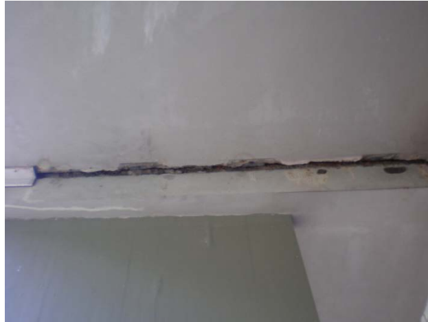
B.2.1. Falta de recubrimiento en junta (Módulo 2-Techo)
