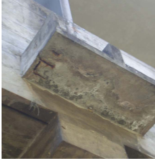
Figura 14. Corrosión del acero estructural
