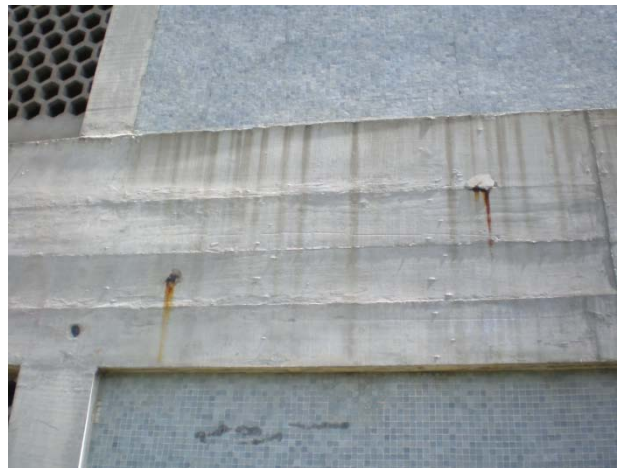
B.3.3. Acero corroído en viga (Módulo 1-Nivel 1)
