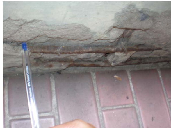
B.2.3. Falta de recubrimiento en columna (Módulo 4-Nivel 1)
