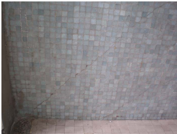
B.5.2. Fisura en mosaico de pared (Módulo 5-Nivel 1)
