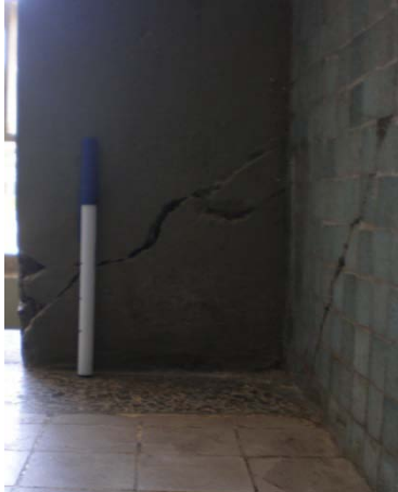
Figura 16. Grietas y/o fisuras
