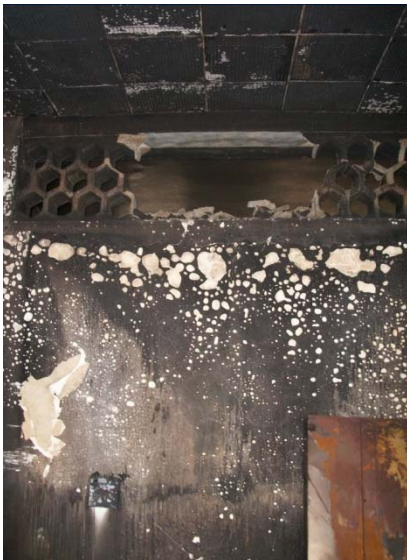
B.7.2. Efecto del fuego en bloques huecos (Módulo 5-Planta baja)
