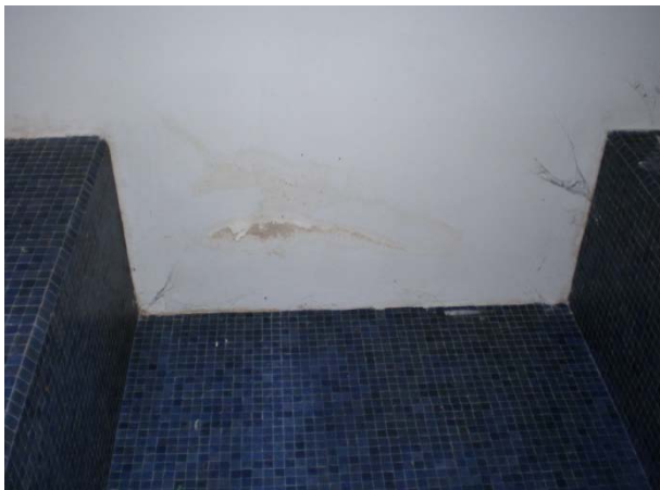
B.1.2. Problema de humedad en losa (Módulo 3-Techo)
