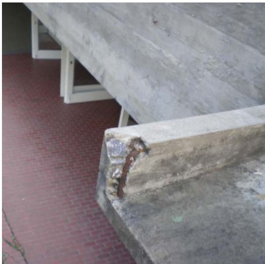
B.3.2. Acero corroído en canal de desagüe. (Módulo 1-Nivel 1)
