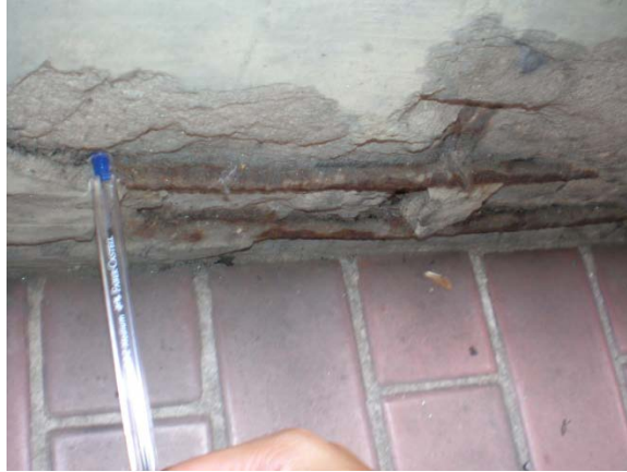
Figura 15. Falta de recubrimiento
