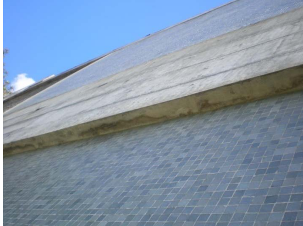
B.1.1. Problema de humedad en viga (Módulo 1-Nivel 1)
