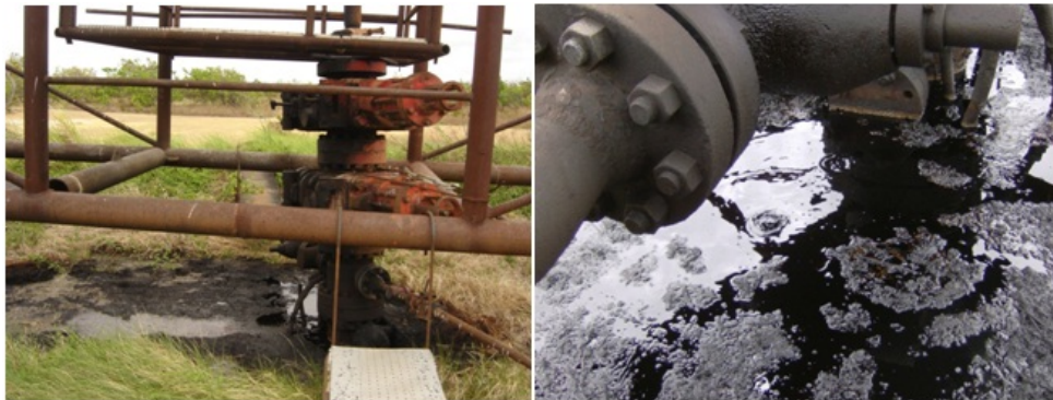
Figura 4.9: Pozo de gas BRV-24. A la derecha emanaciones de gas en la base.
